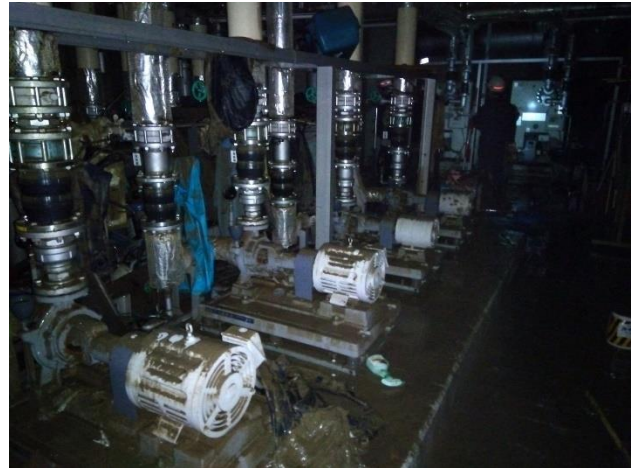
泥が被った地下機械室
