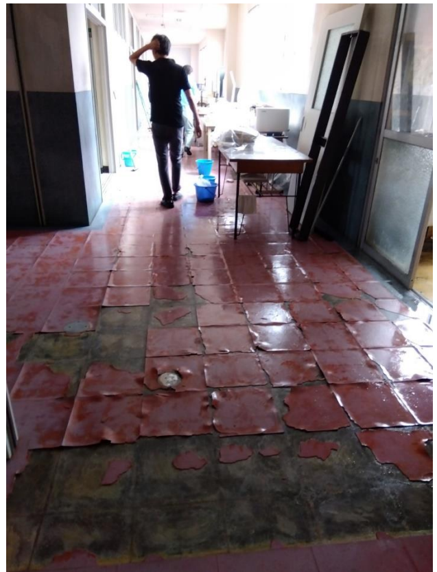
タイルが破損
