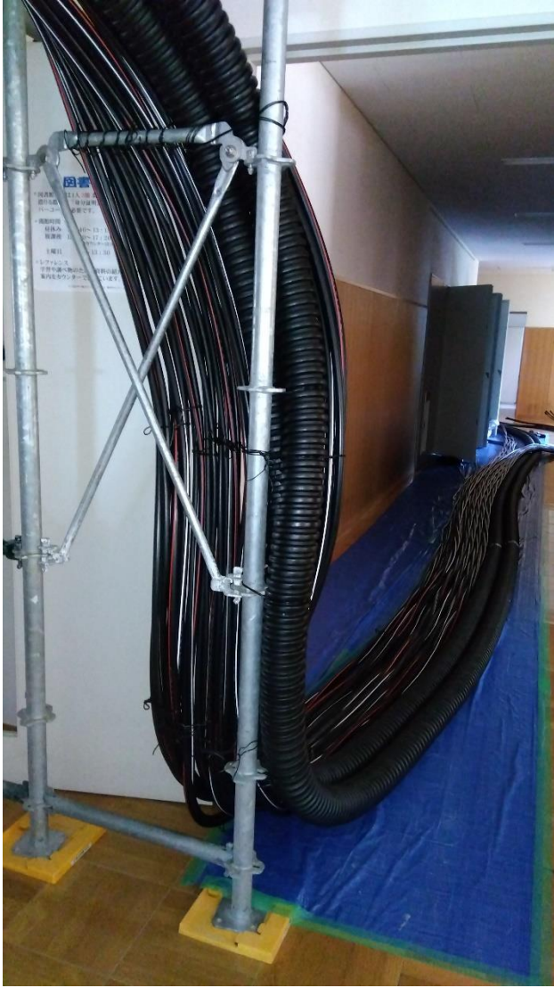
仮設置された電気設備
